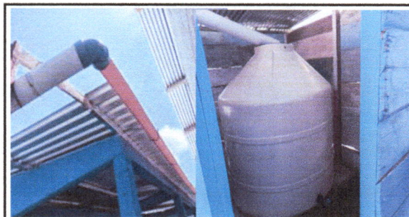
Foto 4: Captación de agua de lluvia.
